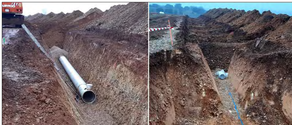
Ilustración 306.- Ejemplo de frente de tapado de las zanjas en la instalación de las tuberías enterradas de la red de riego.
