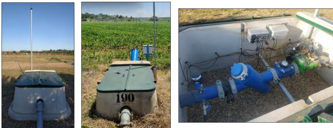
Ilustración 36.- Ejemplos de arquetas de hidrante y de los componentes instalados en su interior.
