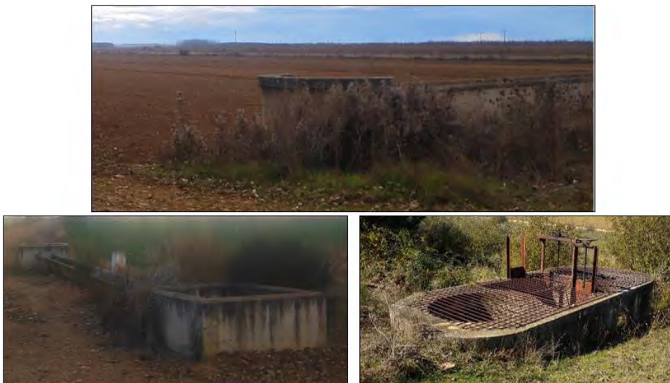
Ilustración 304.- Acequias, arquetas y repartidor de agua de la infraestructura de riego actual en los sectores II y III.
