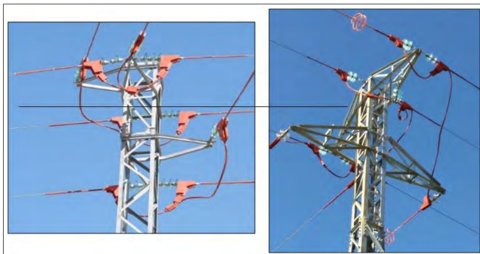
Ilustración 321.- Ejemplo de medios antielectrocución en los apoyos de los tendidos eléctricos.
