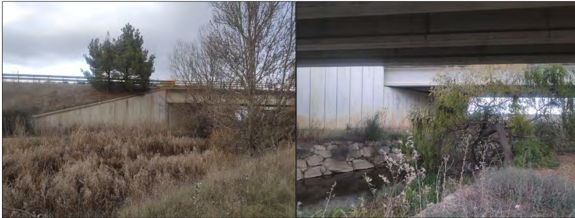
Ilustración 312.- Ubicación n.º 3. Vegetación en el cauce y paso bajo la autovía A-231 León-Burgos (izquierda). Escollera y vegetación en el cauce bajo el paso de la autovía A-231 (derecha). Coordenadas UTM ETRS89 H-30: X: 299105 Y:4703070.
