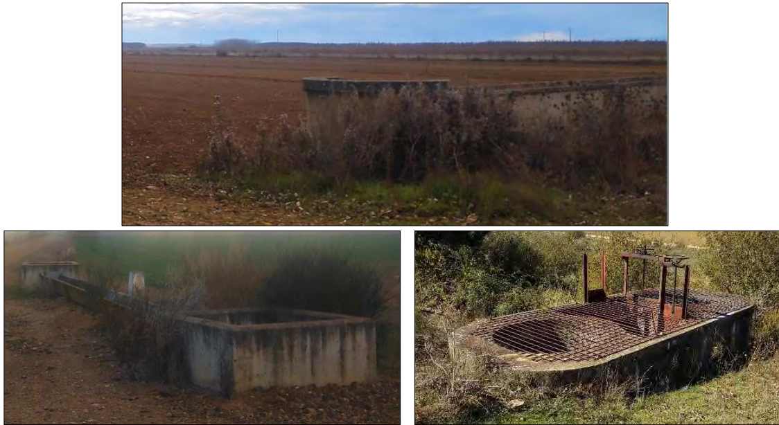
Ilustración 46.- Acequias, arquetas y repartidor de agua de la infraestructura de riego actual en los sectores II y III.
