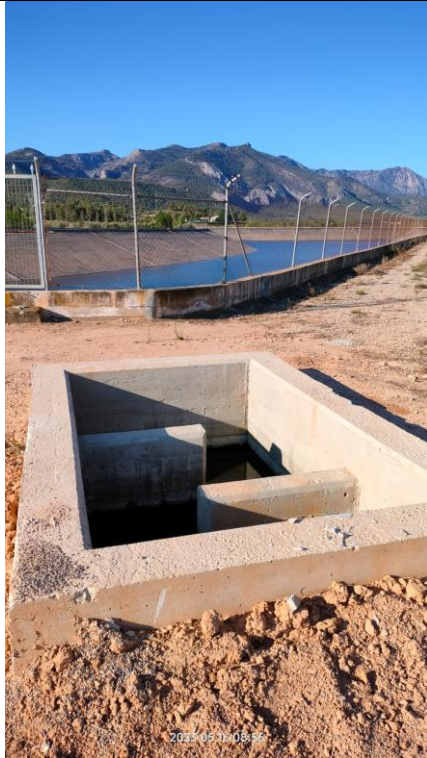
En esta imagen se visualiza el desarenador de la obra de entrada con las aguas procedentes del sondeo, la conducción de entrada es de 500 mm de diámetro (a renovar).
