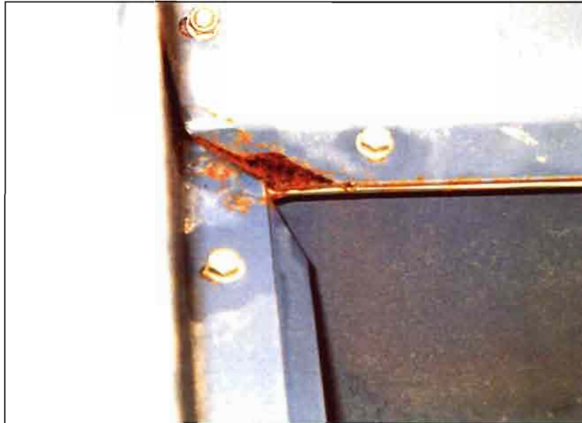
Fig. 5. Detalle de corrosión en una máquina de tres años.
