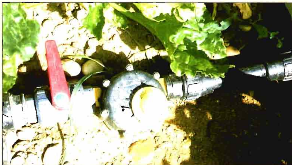
Contador volumétrico utilizado en riego por goteo de remolacha.
