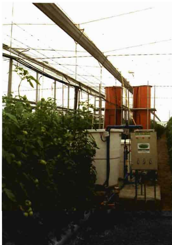
Sistema de filtro lento en arena instalado en el invernadero.
