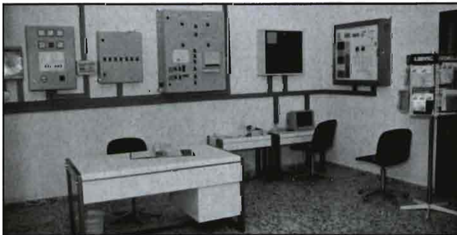
Sala de control de los sistemas de fertirrigación, calefacción e inyección de CO 2 y automatismos de cierre y apertura de las pantallas Ludvig Svensson.
