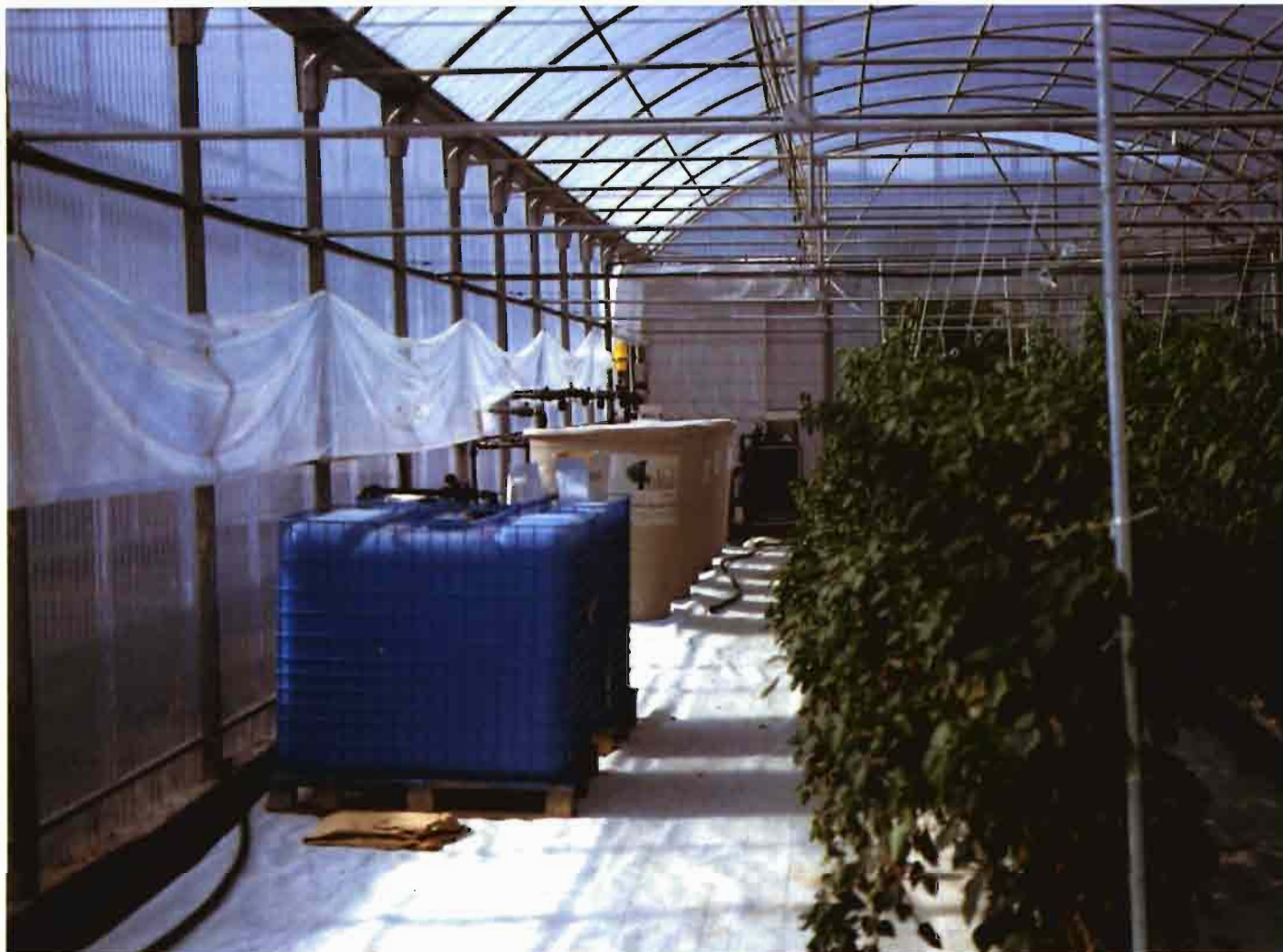
Depósitos de almacenamiento de solución de drenaje tratada por U.V.
