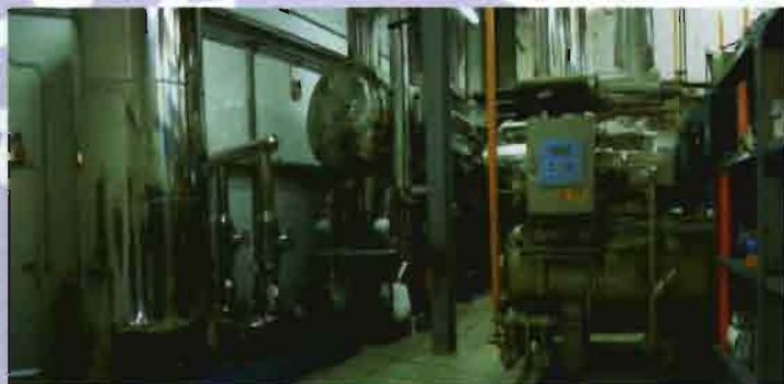
Sala de máquinas 1
