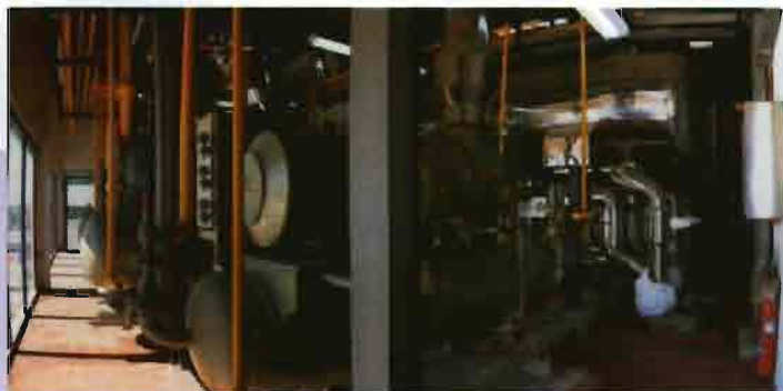
Sala de máquinas 2
