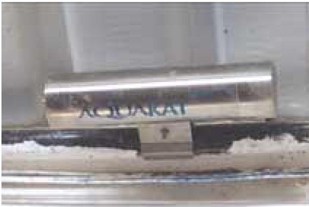
4. Aquakat o catalizador en la tubería del agua
