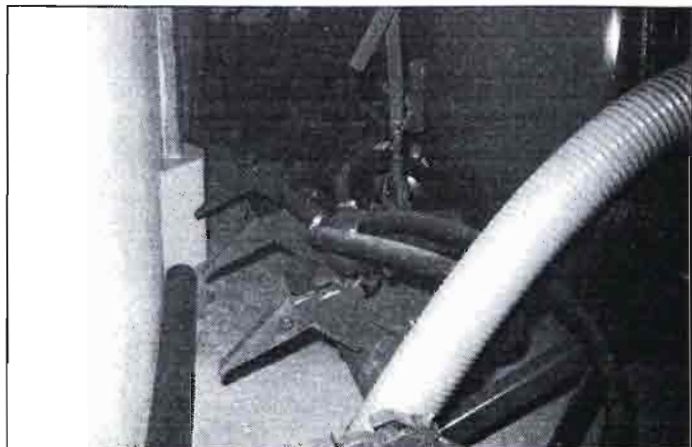
Cisterna y sistema de inyección de la cisterna del S.I.A.
