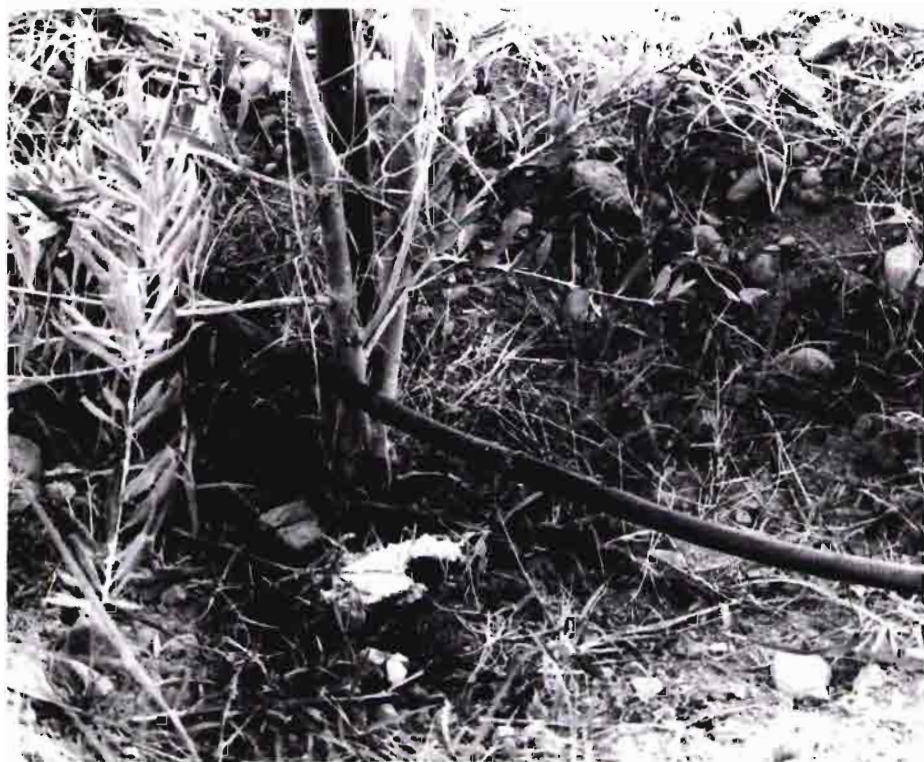
Instalación experimental de riego "por goteo" en finca de Almodóvar (Córdoba)
