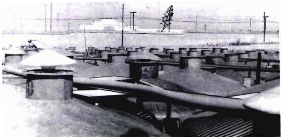
Instalaciones de la Cooperativa Olivarera de Utrera (Sevilla), dedicada al aderezo de aceitunas en verde, visitada por los asistentes al seminario
