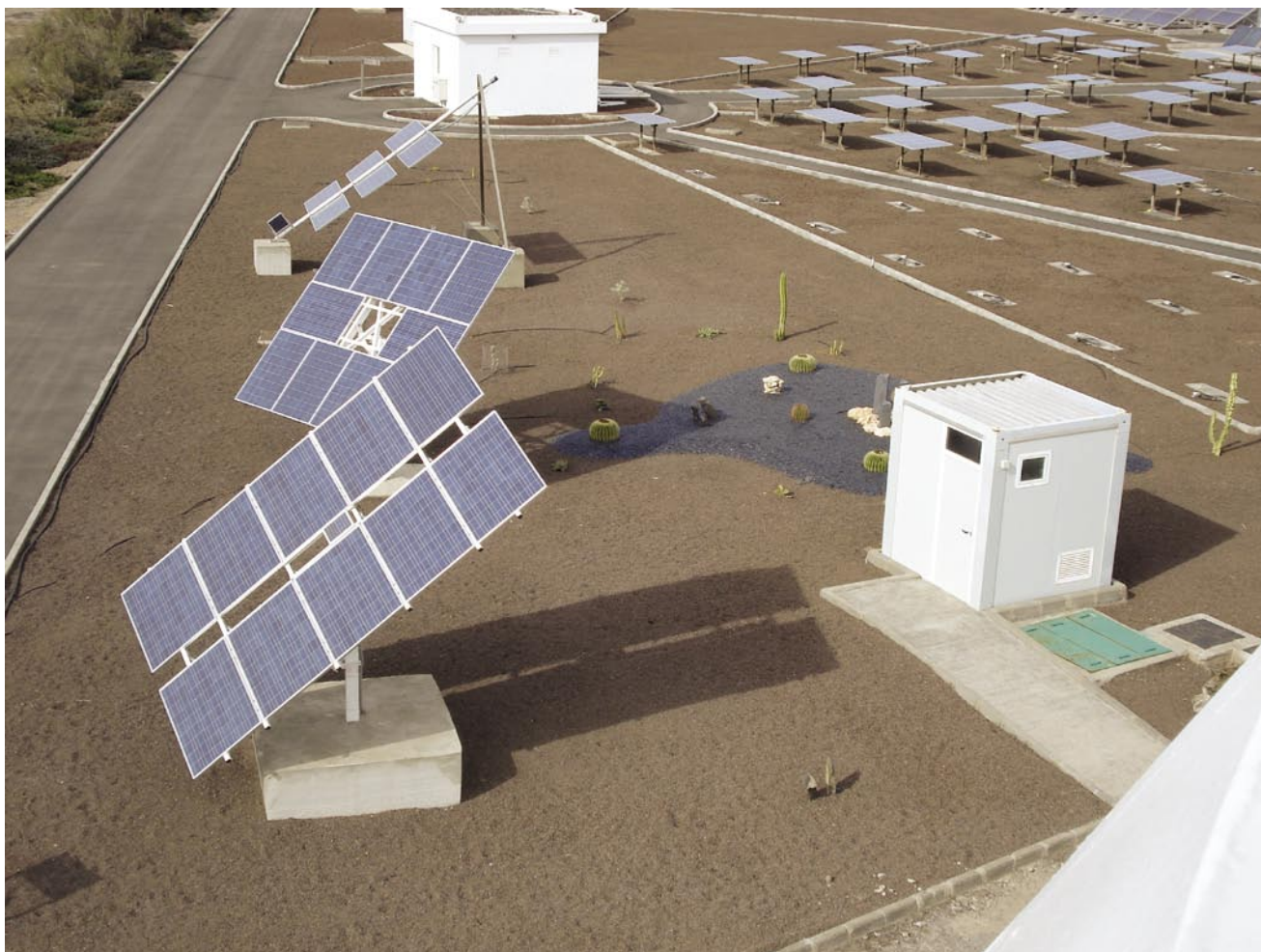
Campo fotovoltaico para sistema autónomo de desalación por energía solar (DESSOL©) en Pozo Izquierdo – Gran Canaria (fuente: ITC)
