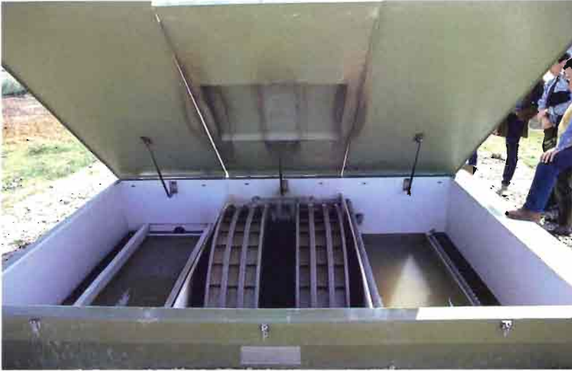
Fig. 10.- Depuración mediante sistema de biodiscos. P.E. Carrión de los Céspedes.
