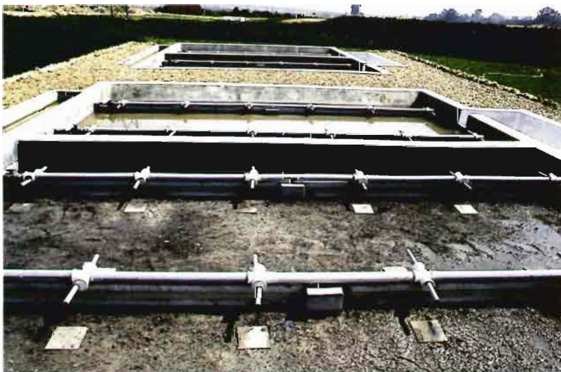
Fig. 6.- Depuración de aguas residuales mediante filtros de turba. P.E. Carrión de los Céspedes.
