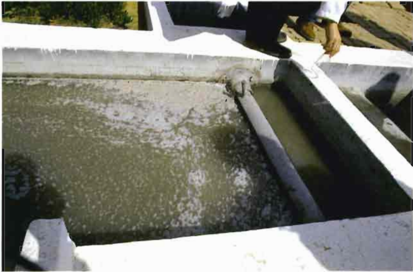
Fig. 12.- Detalle de un desengrasador antes de la entrada en los filtros de turba. P.E. Carrión de los Céspedes.
