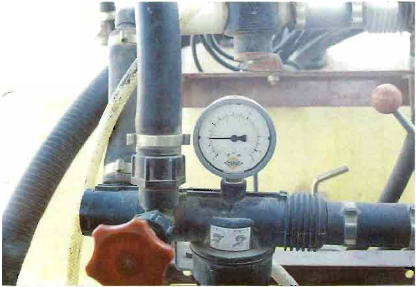
Fig. 6.—La presión debe mantenerse entre 2 y 3 bars.
