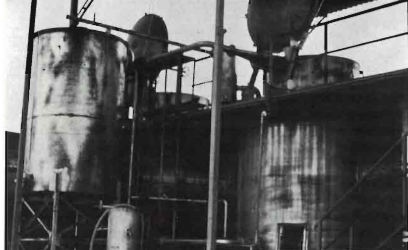
Fig. 4.—Destilería moderna con dos calderas de 6.000 litros cada una, en Guadalajara.
