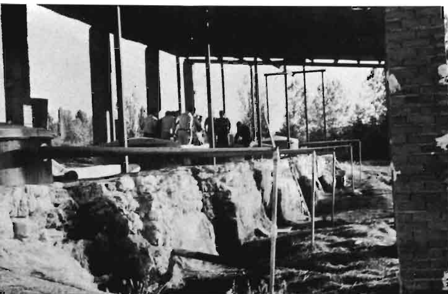
Fig. 2.—Instalación de una batería de calderas de destilación a fuego directo.
