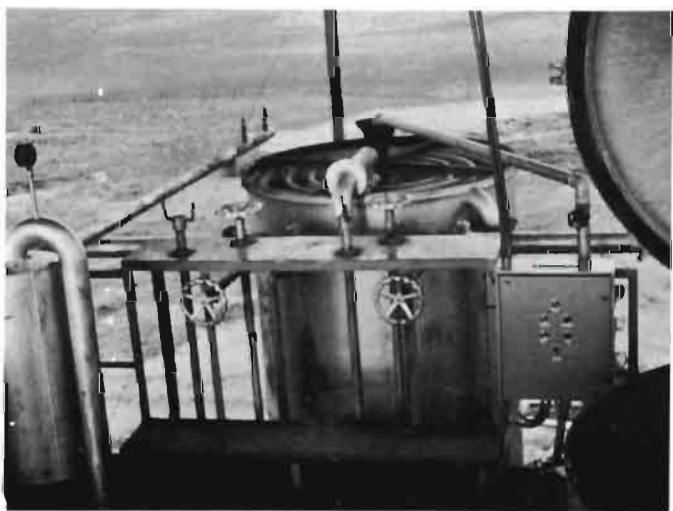
Fig. 6.—Detalle del serpentín refrigerante, en una destilería moderna.
