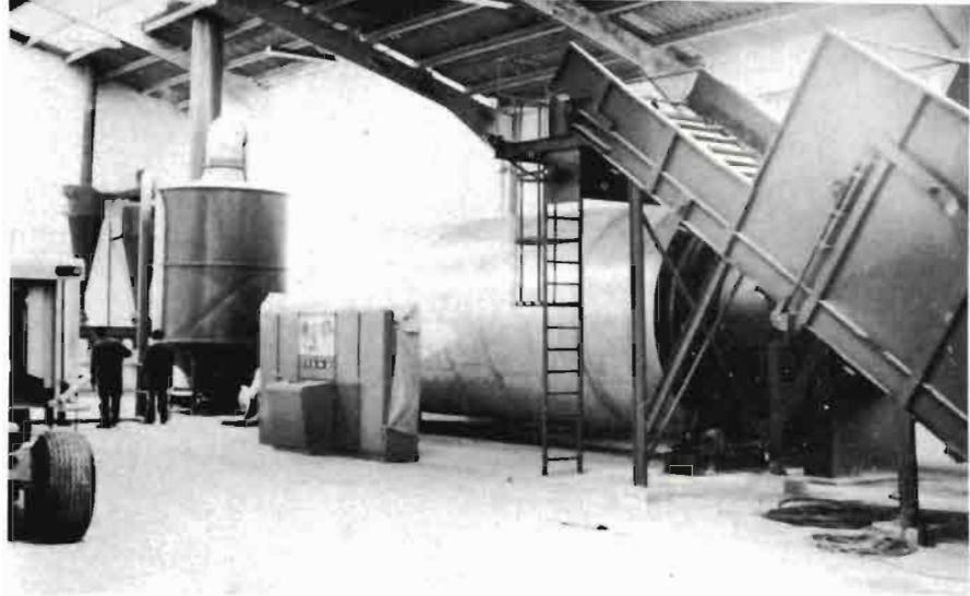
Fig. 4.—Vista general del interior de la planta de deshidratación.
