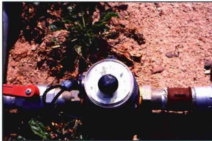
Contador-dosificador volumétrico instalado en un ramal de riego.
