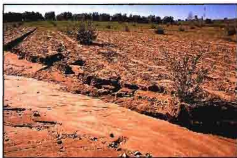
Cuando el suelo ha sido labrado, como en este olivar joven, las cárcavas se forman fácilmente en los desagües y vaguadas.
