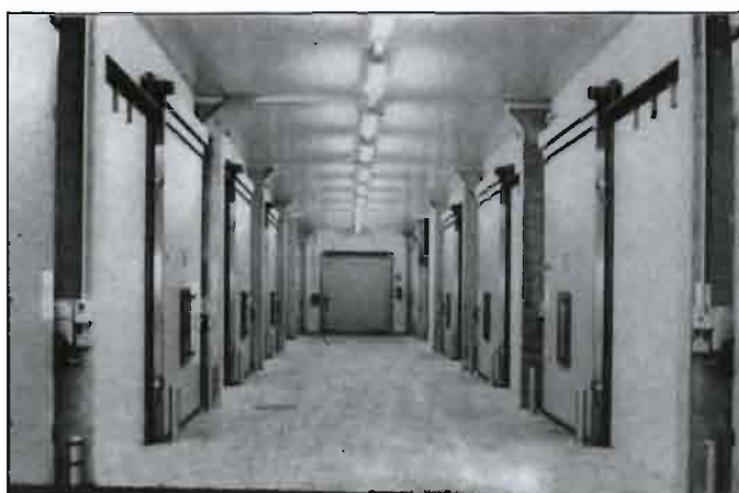
En las fotografías superiores se ven los salones de control de cuartos de atmósferas controladas. Imágenes pertenecientes a la empresa Isolcell de Italia.
