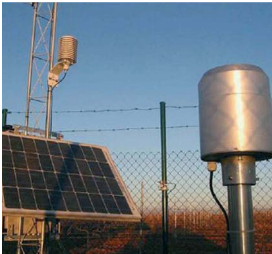
Panel solar, pluviómetro, sensor temperatura y humedad.
