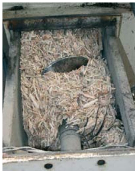
Productos orgánicos y subproductos vitícolas en la caldera de biomasa.
