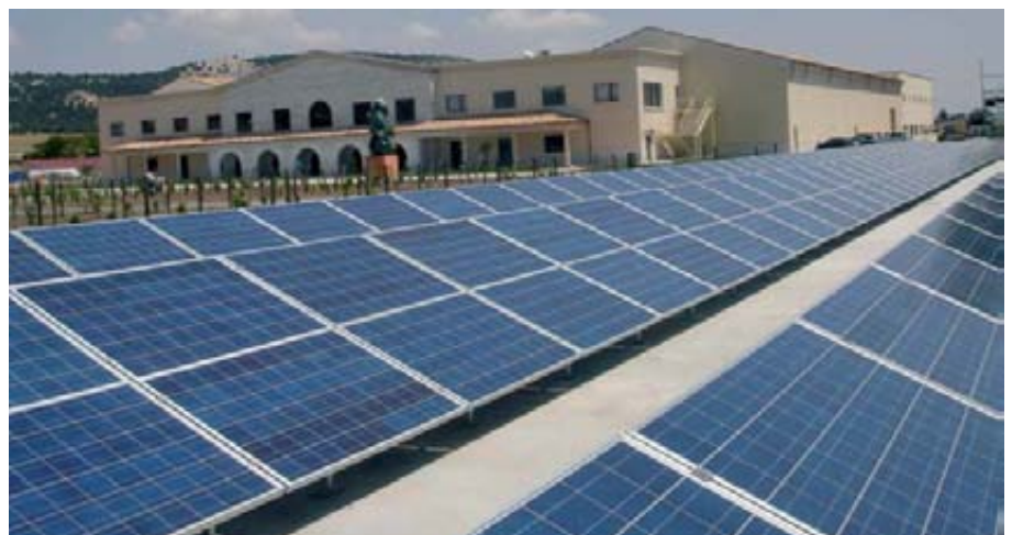
Paneles de energía solar fotovoltaica en la bodega Emina de Valbuena de Duero.
