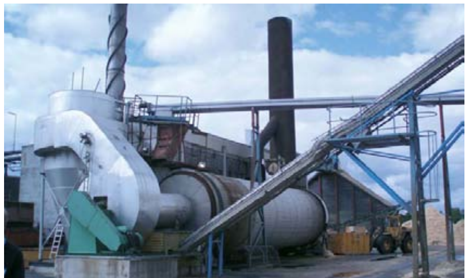
Foto 4. Aspecto del secadero en una fábrica de pélets de 80.000 t/año en Suecia.
