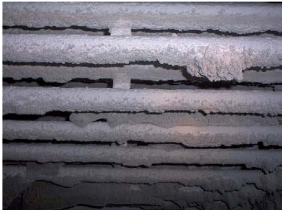
Escorias adheridas a sobrecalentadores horizontales (central térmica de Sangüesa).
