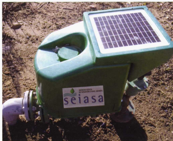
Hidrante con placa solar.
