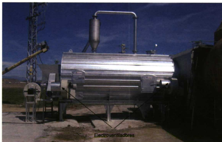
Foto 4. Localización de los electroventiladores en un horno de combustión de biomasa.
