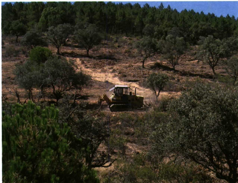
Máquina subsolando el suelo para la preparación previa a la repoblación forestal.
