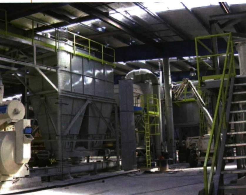
Vista de una planta de peletizado.
