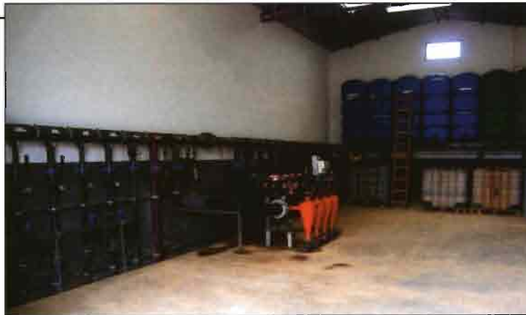
La instalación ha sido diseñada para el riego subterráneo de las distintas parcelas de cultivo.
