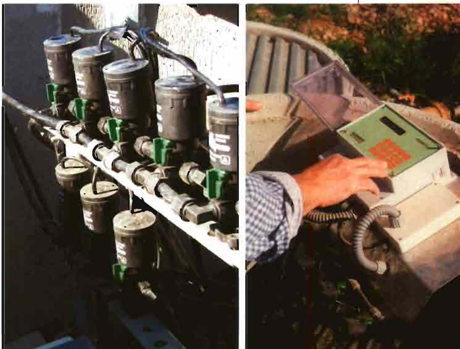
Solenoides que controlan distintas válvulas de riego y programador de riego.
