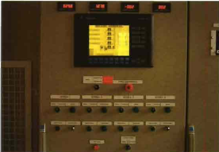
Panel de control de una estación de bombeo compuesta por cuatro grupos matabomba.
