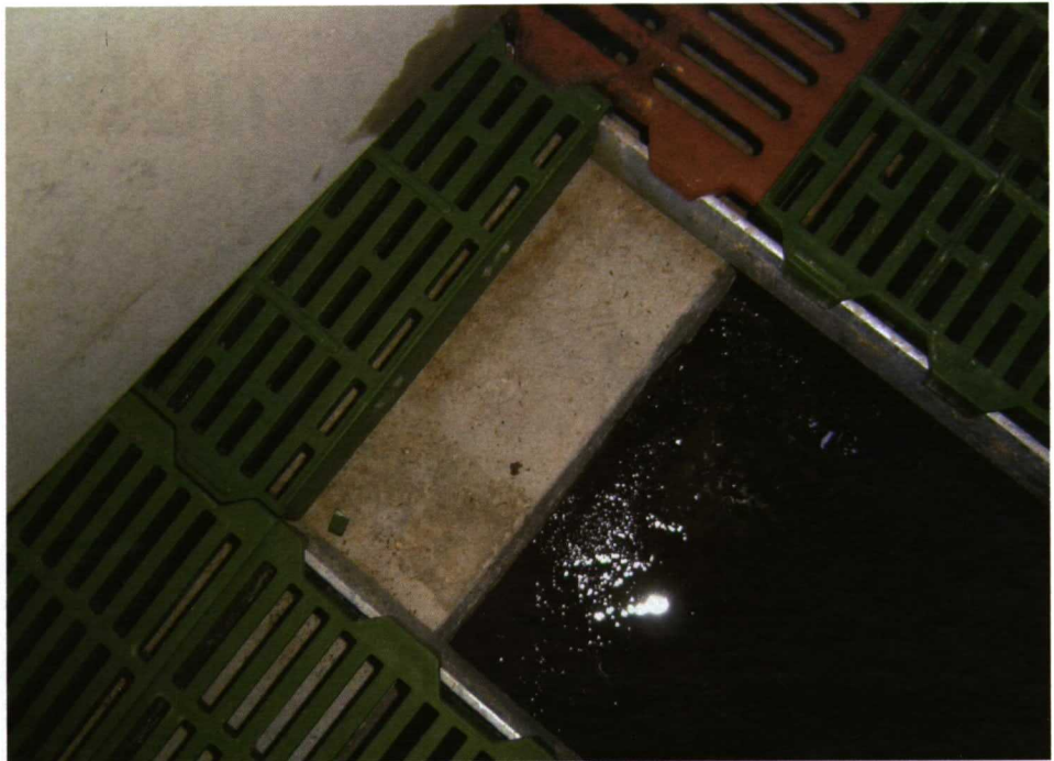
Para el control de la enfermedad es imprescindible el vaciado y limpieza de las fosas.
