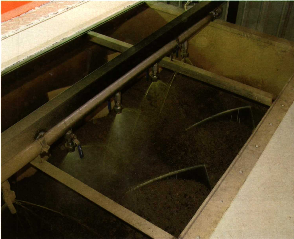
Figura 2. Interior de la mezcladora.
