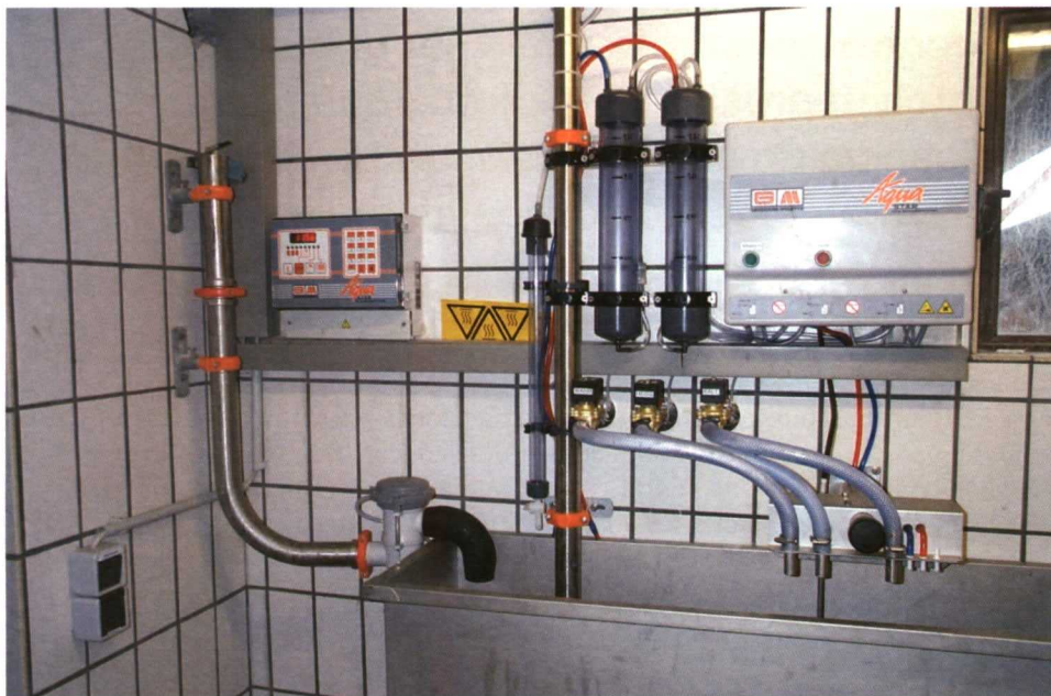
Foto 3. Programador de lavado automático de última generación.
