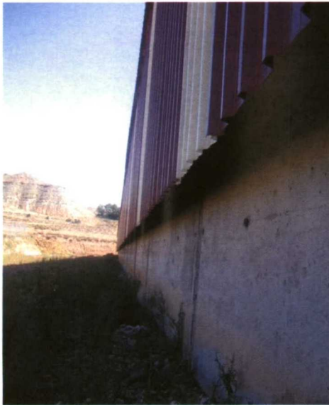
Figura 4. Retranqueo en fachada para entrada de aire en una ventilación estática vertical.
