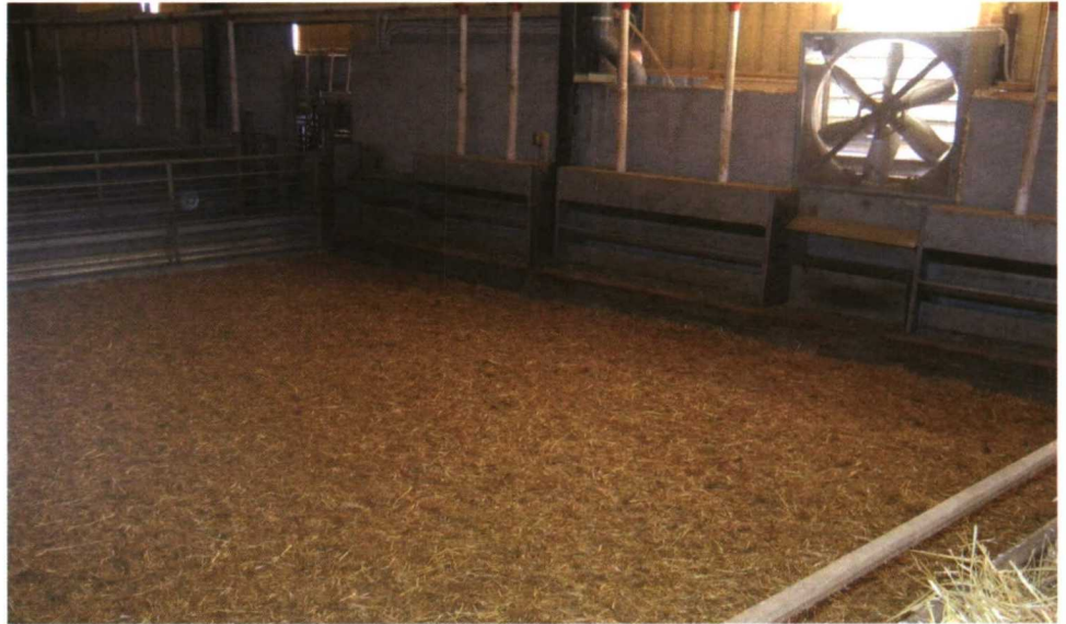
Figura 5. Extractor situado en pared lateral de alojamiento ganadero en un sistema de ventilación dinámica.
