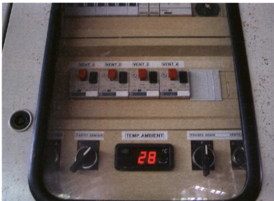
Foto 10. Cuadro de control de ventilación por sensores de temperatura.
