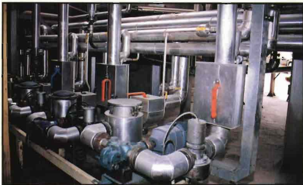
Líneas de líquidos y equipos de bombeo.
