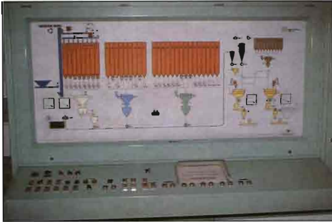
Panel informatizado del control del proceso productivo.
