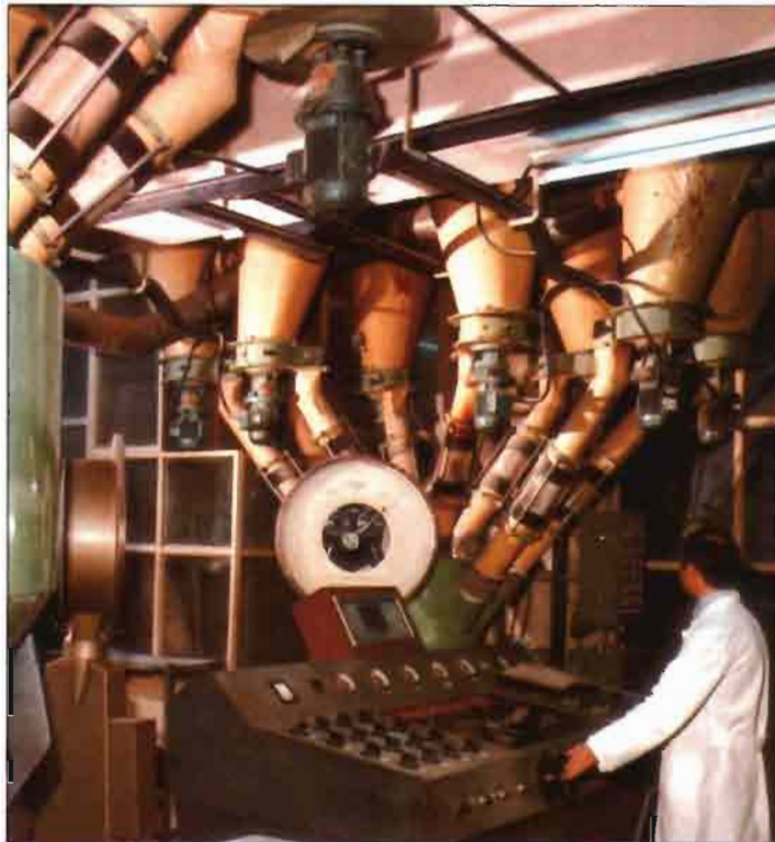
Instalaciones defectuosamente ubicadas o no idóneas producen mal y no satisfacen ni a la protección de la calidad ni a la del medio ambiente en general o a la de trabajo en particular.
