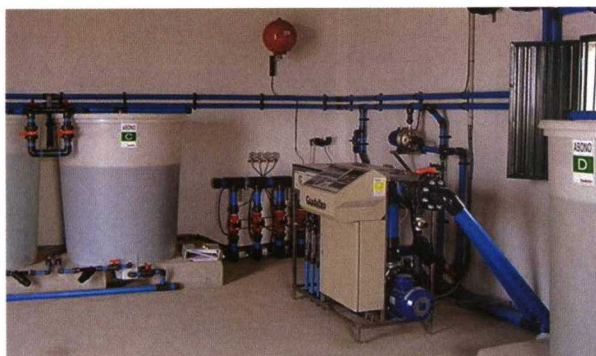
Cabezal de fertirrigación con controlador de riego y depósitos de solución de abonado.
