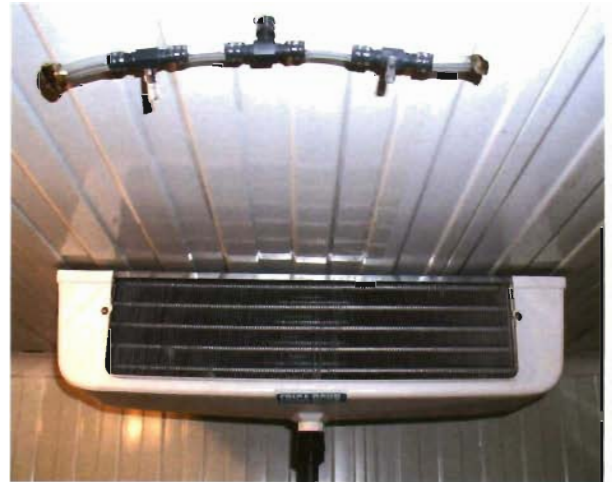
Situación del distribuidor del ozono, para facilitar la homogenización de la atmósfera interior.
