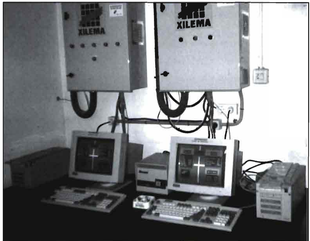
Control mediante ordenador de los procesos relativos a la fertirrigación en estación remota, fuera del lugar de ubicación de los equipos y cultivos.
