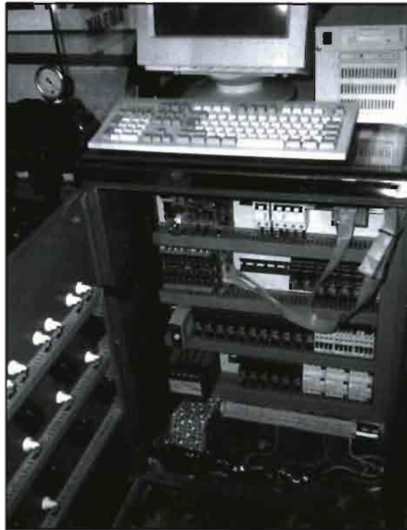
Detalle del cuadro eléctrico de un equipo automático de fertirrigación.
