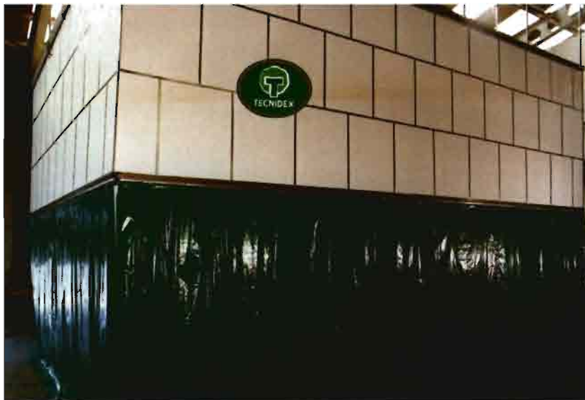
Cámara de desverdización-maduración multiuso. Foto: Tecnidex.
