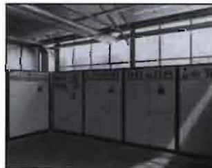
Automatizaciones (paneles de mandos).
