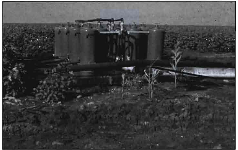
Cabezal con filtro de arena (Foto: Regaber).
