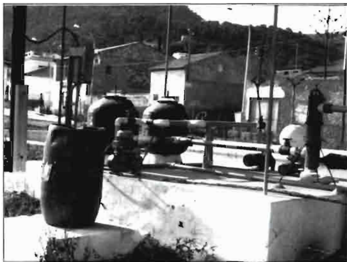
Cabezal de riego con inyector eléctrico de fertilizantes.
