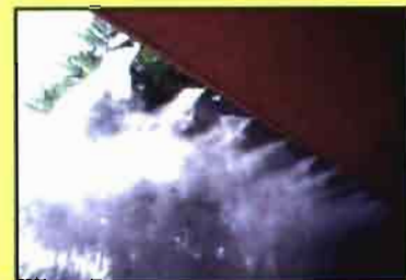
FOG SYSTEM HUMIDIFICACIÓN-REFRIGERACIÓN - SEMILLEROS-CÁMARAS- MEDIOAMBIENTE
