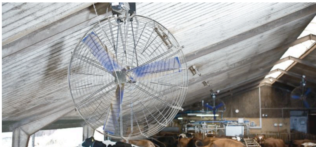
Ventilador para la renovación del aire en naves con ganado vacuno.
