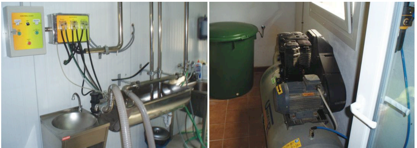
FOTO 2. Vista de salas de ubicación de equipos relacionados con el ordeño: lavado y bomba de vacío. La limpieza de todos los locales debe formar parte de la rutina diaria del ordeño
