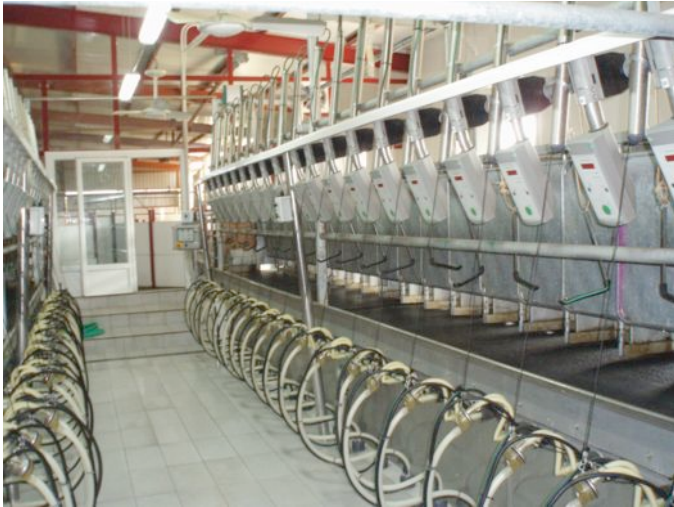
FOTO 3. Vista de sala de ordeño, una vez realizado el lavado de la máquina y la limpieza del local
