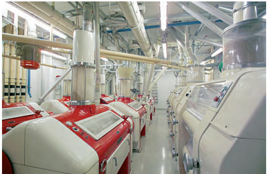
FOTO 1. El uso combinado de convertidores de frecuencia de CA de baja tensión junto con motores eléctricos ayuda a mejorar el proceso y a incrementar el ahorro energético en bombas, ventiladores y otros equipos
