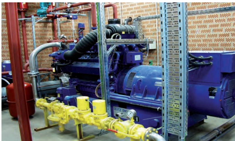
Grupo de cogeneración en caseta de obra. Lo normal es en container*
