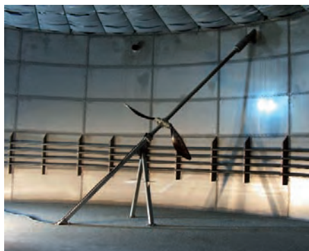
Detalle del interior del digestor*
