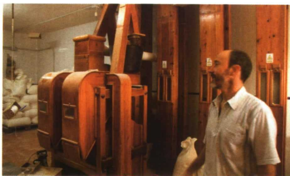
..... Todas las conducciones y maquinarias están revestidas de madera de pino y haya. Se puede ver parte de los elevadores que suben el grano al molino
